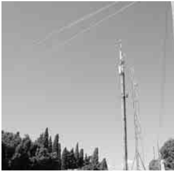
UN'ANTENNA DI TELEFONIA MOBILE INSTALLATA IN CITTÀ
